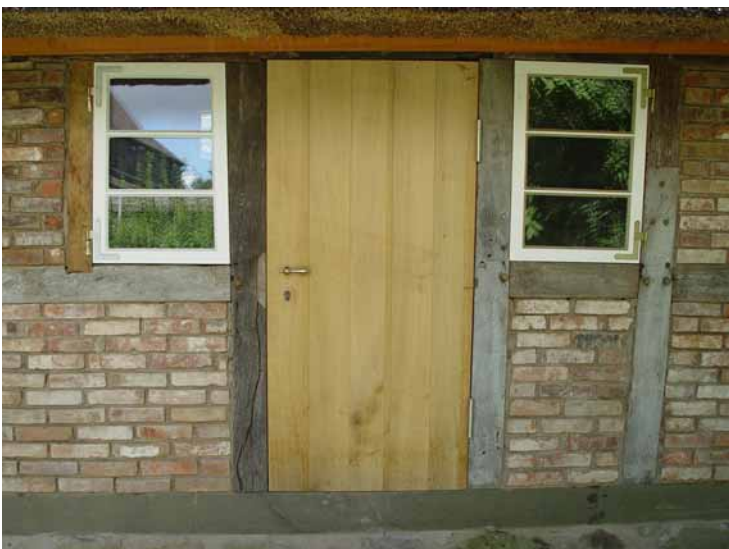
Die neuen Fenster wurden per Handarbeit angefertigt, angepasst und eingesetzt. Dies war notwendig, da das Fachwerk aufgrund seines Alters in sich schief ist.
